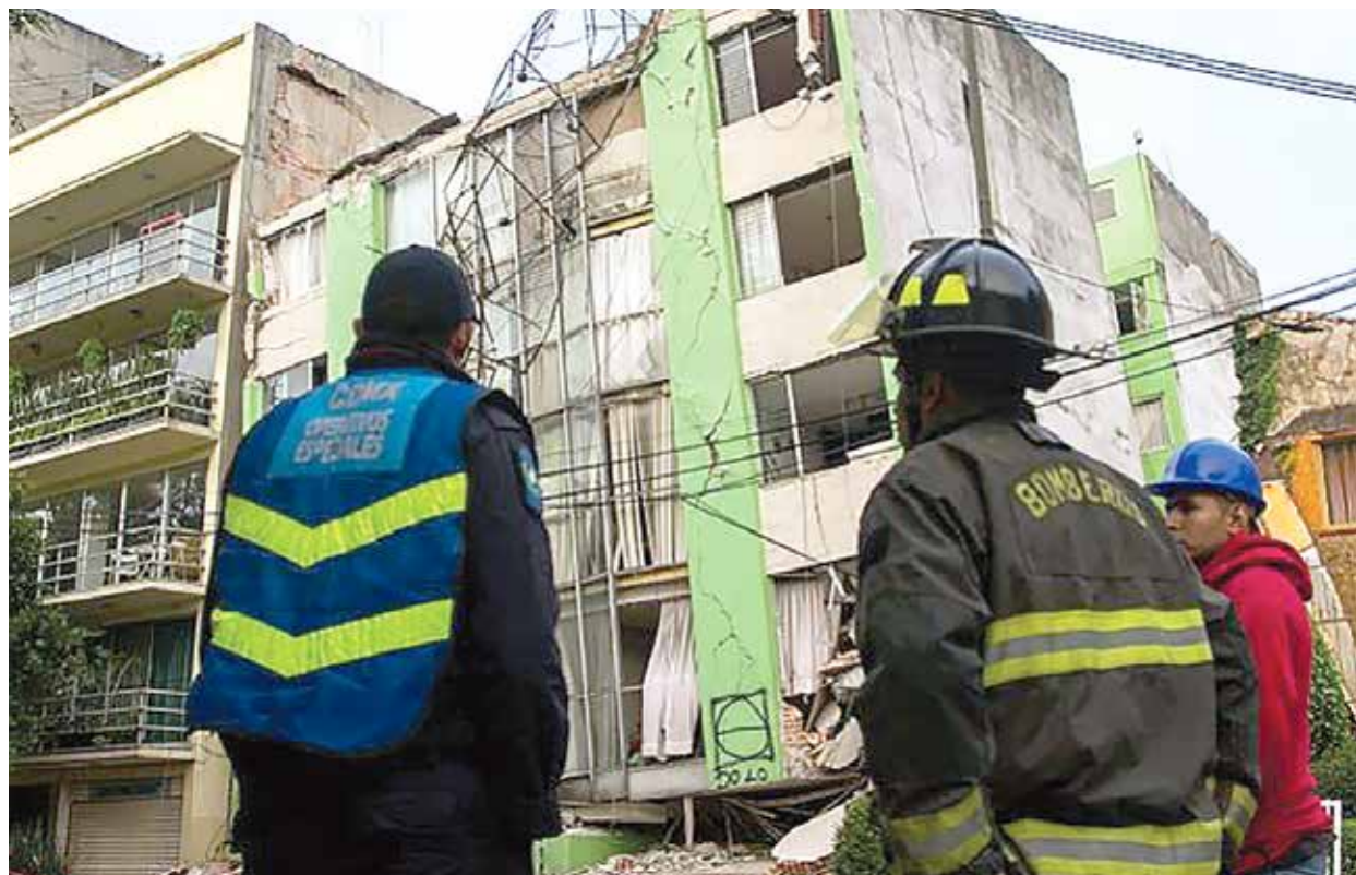
El edificio colapsado en Rebsamen 241
